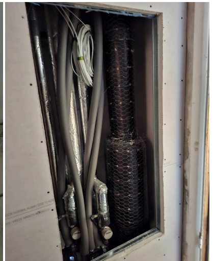
Rør til varme og ventilation samles i et installationsskab i entreen.
