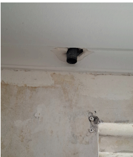
Rør fra de gamle radiatorer ført gennem loftet i boligen
