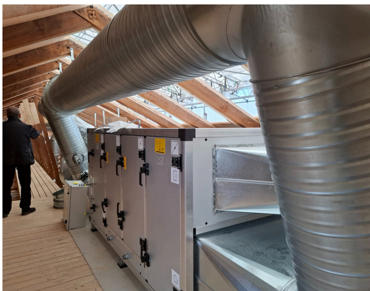
Ventilationsanlægget er placeret på bygningens loftetage
