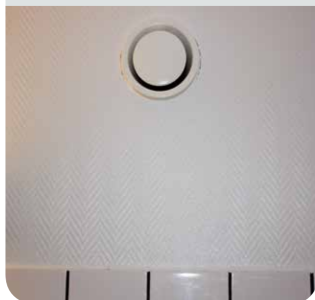
Udsugningsventil Må ikke lukkes/tildækkes
