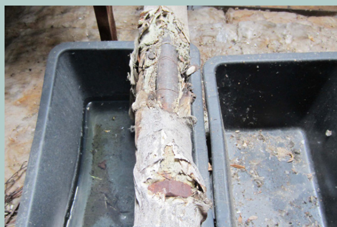
Vandinstallationer er oprindelige. Brugsvandsinstallationer skal udskiftes.
