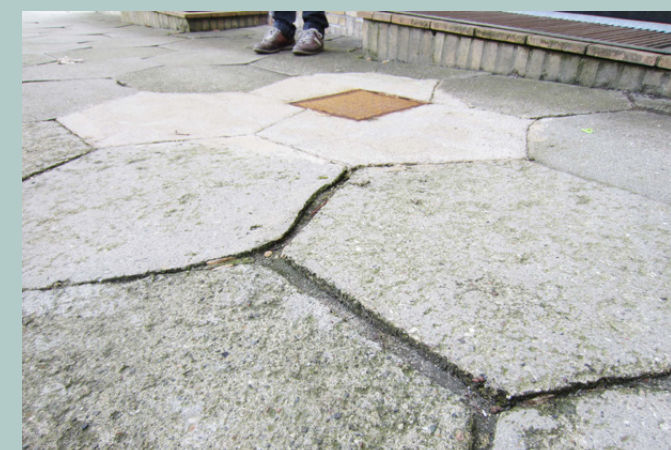
Belægninger med Bellahøj-fliser er porøse og ujævne.
