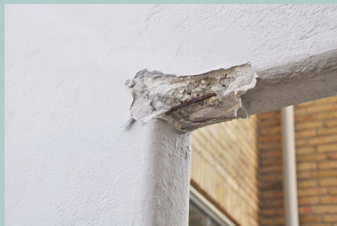
Beton på mellembygninger er nedbrudt.
