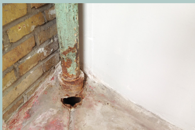
Faldstammer og udvendige nedløb skal renoveres.
