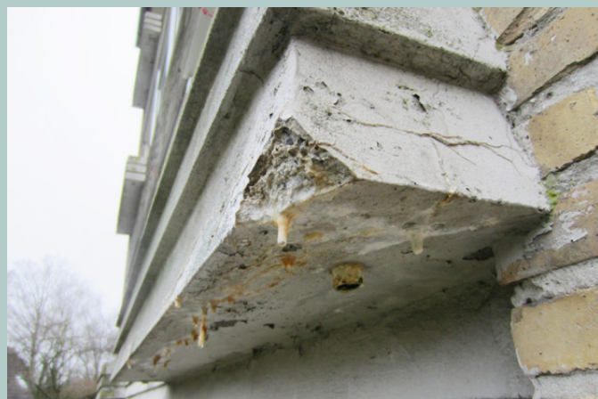
Betonbrystninger og -altankasser er nedbrudte.
