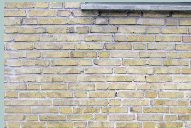
Murværk skal enten omfuges og renoveres eller der kan efterisoleres.
