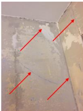
Eksempel på revner i porebetonvægge
