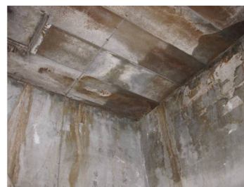
Dæk over kælderadgang til varmecentral, tydelige tegn på utætheder
