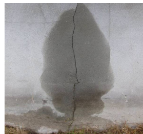
Revne i sokkelpuds
