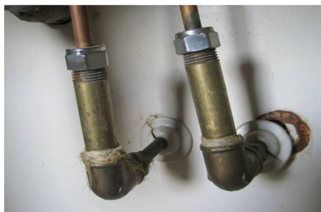
Billedet herover viser tilslutning til køkkenvask, sammenblanding af rørmaterialer
