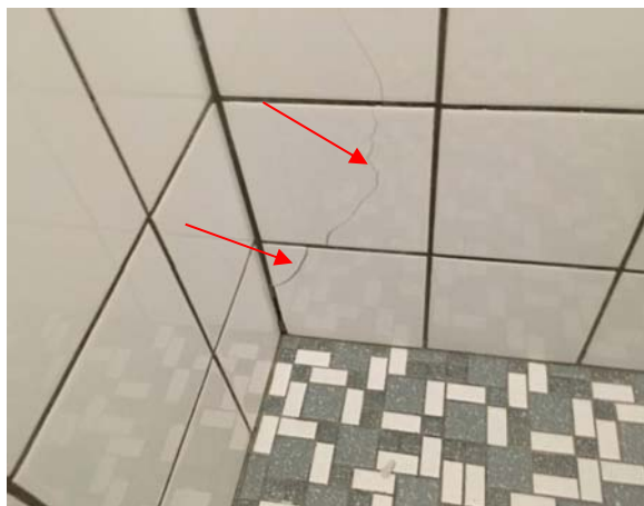
Foto 1 – revnedannelser, jævnt fordelt
