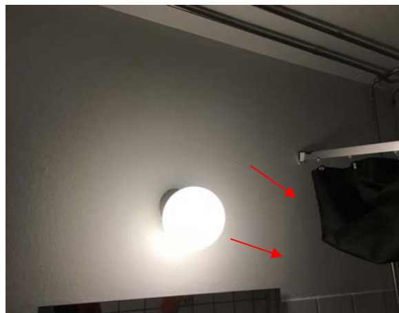
Foto 2 – revnedannelse på skrå/diagonalt
