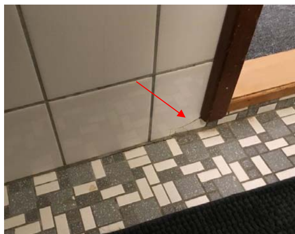
Foto 4 – revnedannelse ved døråbning
