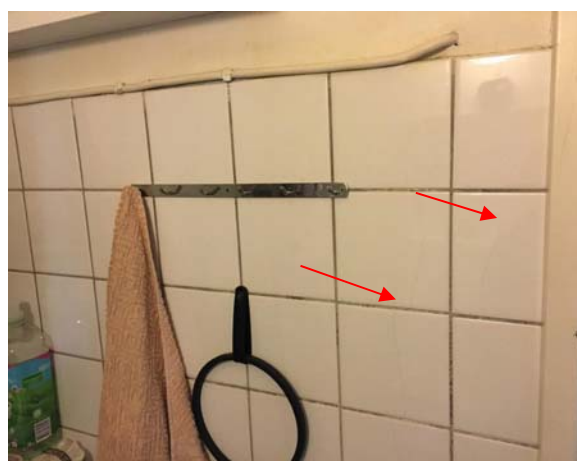
Foto 4 – revnedannelse ved døråbning, diagonal
