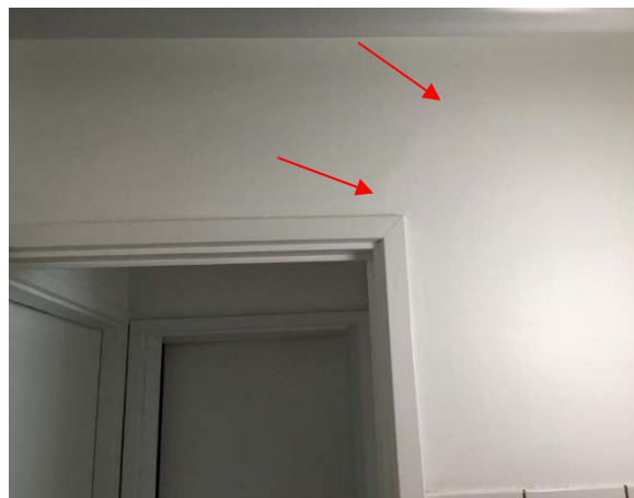
Foto 2 – revnedannelse ved døroverligger
