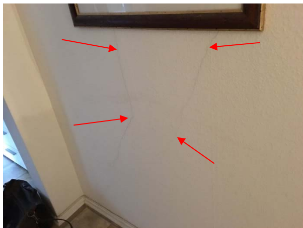
Foto 1 – revnedannelser, jævnt fordelt
