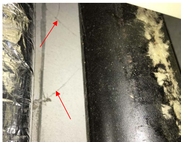
Foto 4 – revnedannelser, jævnt fordelt
