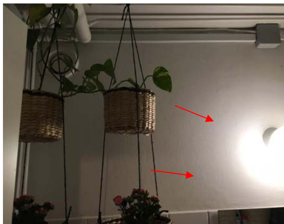
Foto 1 – revnedannelser, jævnt fordelt
