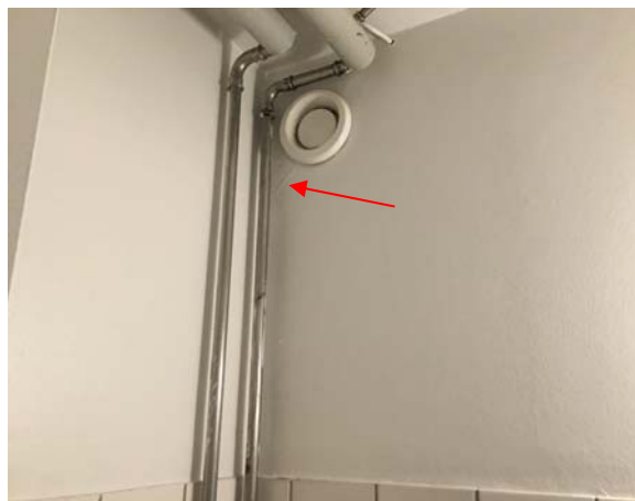
Foto 1 – revnedannelser, ved kontrolventil
