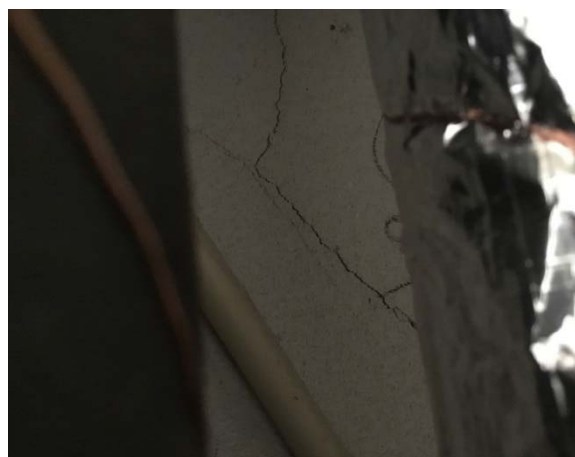
Foto 4 – revnedannelser, jævnt fordelt
