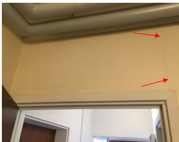
Foto 3 – revnedannelse over døråbning
