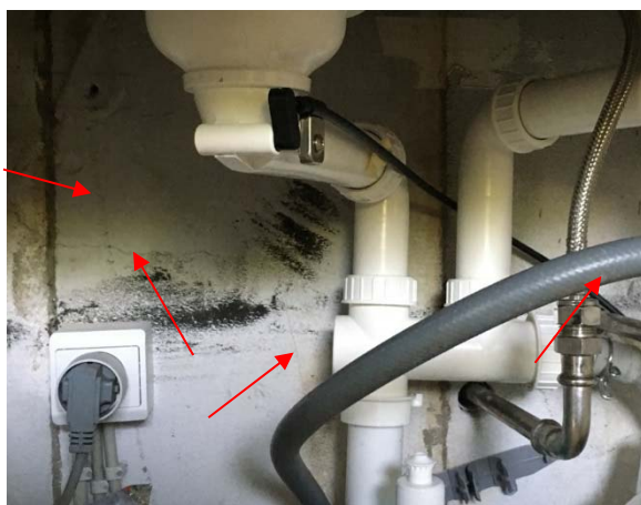
Foto 3 – revnedannelse på skrå/diagonalt
